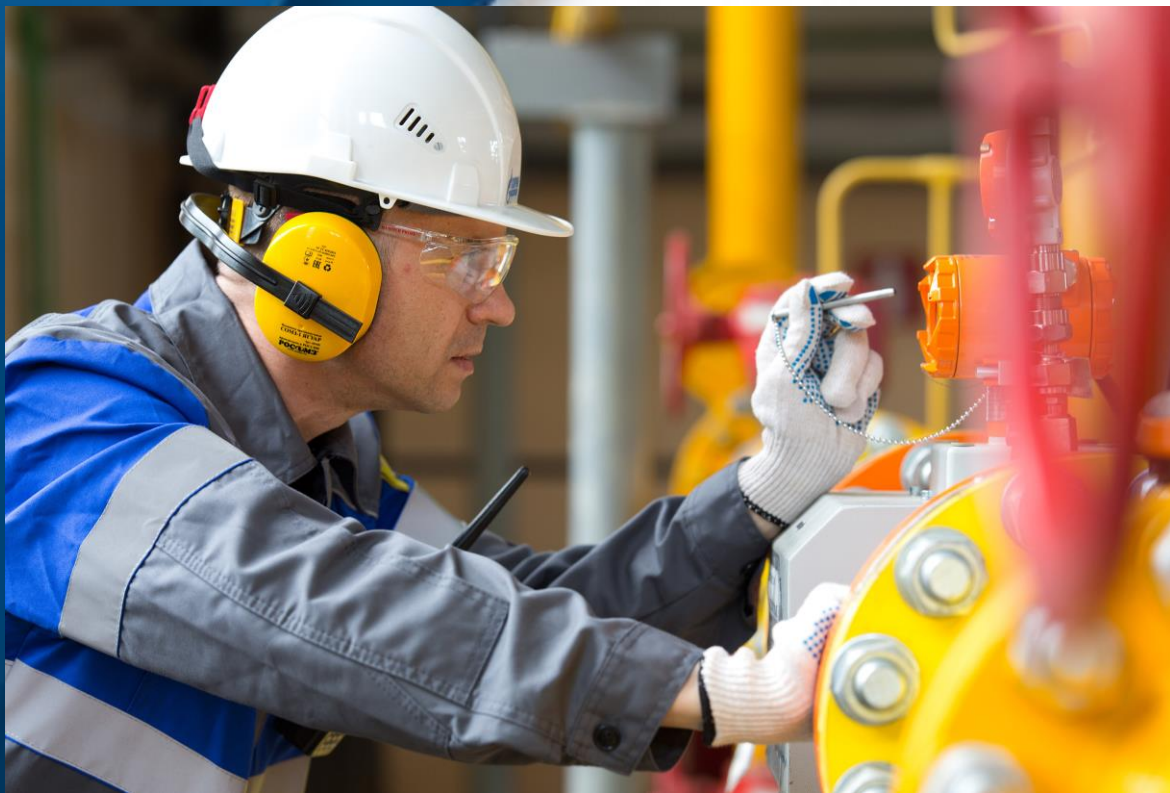
Фоторабота «Проверка параметров расхода газа»
