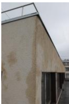
Ж. Повреждения штукатурных поверхностей на фасадах
