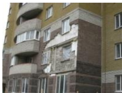
В. Трещины в облицовочном слое на всю высоту здания
