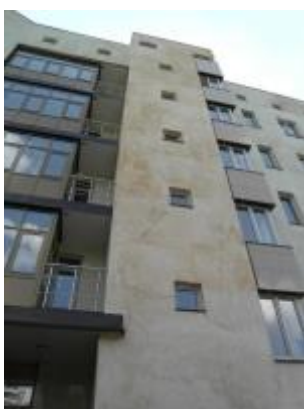
Е. Неплотное прилегание утеплителя к основанию
