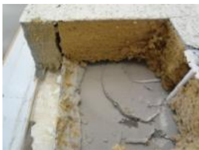
Д. Вертикальные трещины в штукатурном слое
